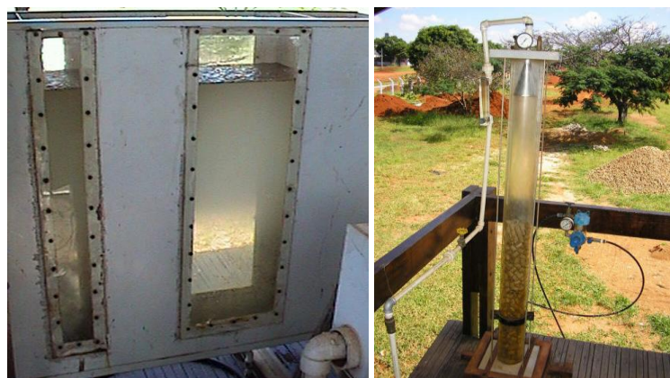
Figura 4.8 – Tanque de flotação e coluna de saturação de ar da ETA-Piloto
