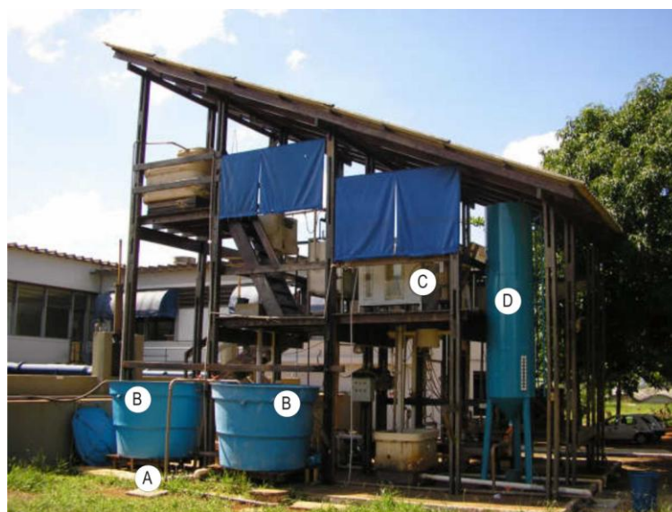
Figura 4.7 – Estação piloto da ETA-Brasília: (A) Chegada de água de lavagem; (B) Tanques de acumulação de água de lavagem; (C) Tanque de flotação; (D) Coluna de sedimentação;
